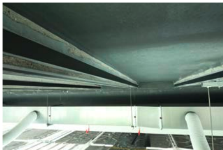
Applizierte Lamellen an den Seiten der Deckenrippen
